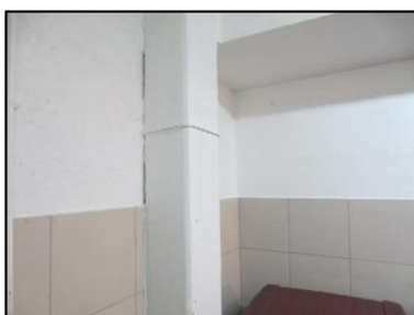
Photo N° 1280 AMIANTE CIMENT -- local VO -1 Murs Ventilation haute (Fibres-ciment)
